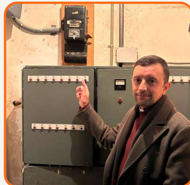
Parrocchia dell'Excollegiata di Santa Maria La Mayor ad Alcañiz – Donazione della Fondazione SAMCA di 6.000 € per la sostituzione del quadro elettrico
